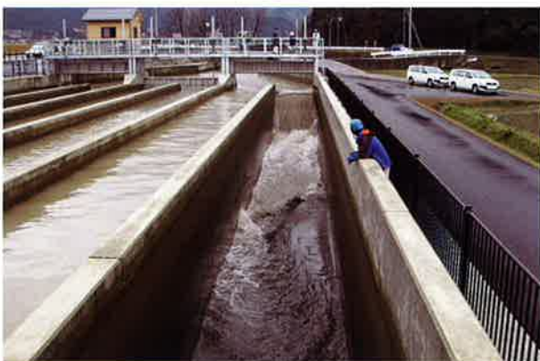
沈砂池に溜まった土砂の状況
