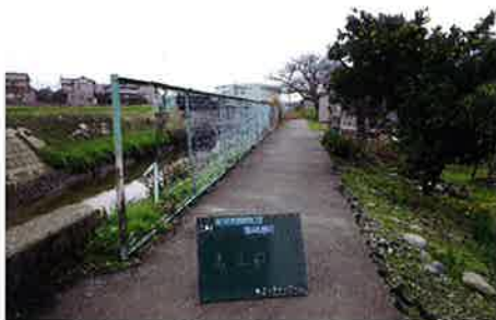
下郷地区転落防止柵
