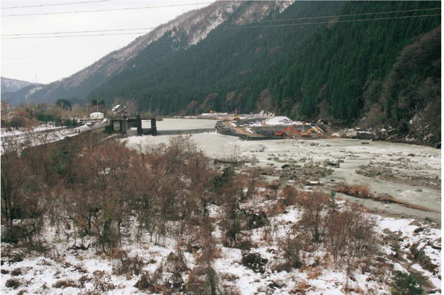
しらやま 工事に着工した白山頭首工(白山市白山町地内) 平成26年12月撮影
