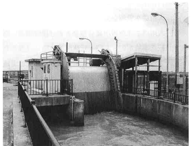
発電取水口除じん機
