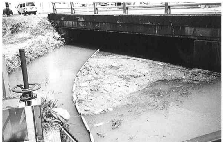
水路に投棄され、溜まったゴミ 小松市梯町地内西川用水
