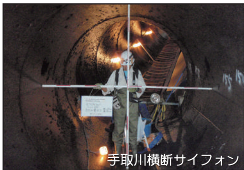
③ 手取川の川底にある用水を通すためのトンネルです。直径2メートル以上あり、普段は用水で満たされています。
