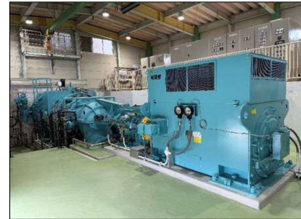
全てが更新された水車発電機
