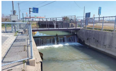
「宮竹用水地区」 遠隔監視・操作システム 江上水門ほか (能美市・小松市内)
